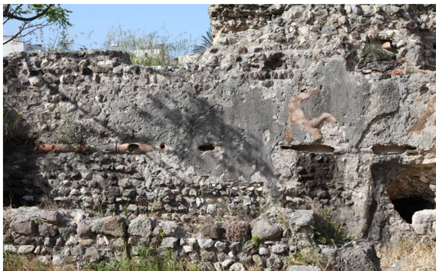
Fig. 24. Kos, Terme Occidentali, parete meridionale del calidario sud: si notino le condutture di adduzione nella muratura (foto G. Rocco).
