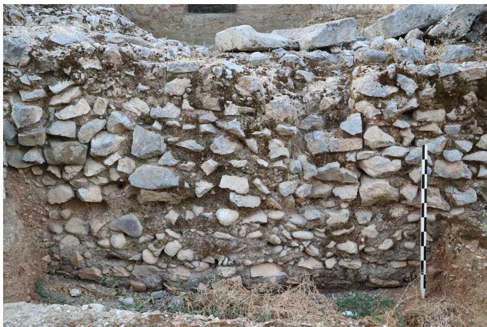
Fig. 20. Muro b , lato esterno. Fondazioni costruite in cavo libero: si noti la differenza della composizione delle gettate di cementizio.
