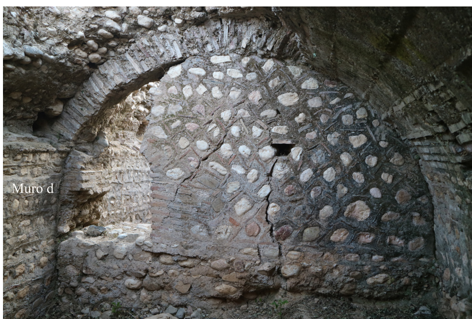
Fig. 22. Ambiente M, parete nord: le fondazioni costruite in cavo libero si appoggiano al paramento del muro d . Si noti anche la scarsa qualità della muratura, l'uso di frammenti di vario materiale per la realizzazione dell'arco e degli stipiti dell'apertura e la tessitura della volta, caratterizzata da spessi letti di malta posti tra i laterizi.
