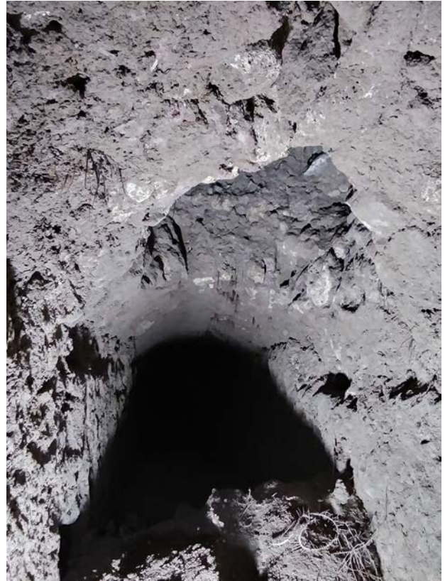
Fig. 18. Cedimento della volta riscontrato nel tratto c del collettore (foto Autore).
