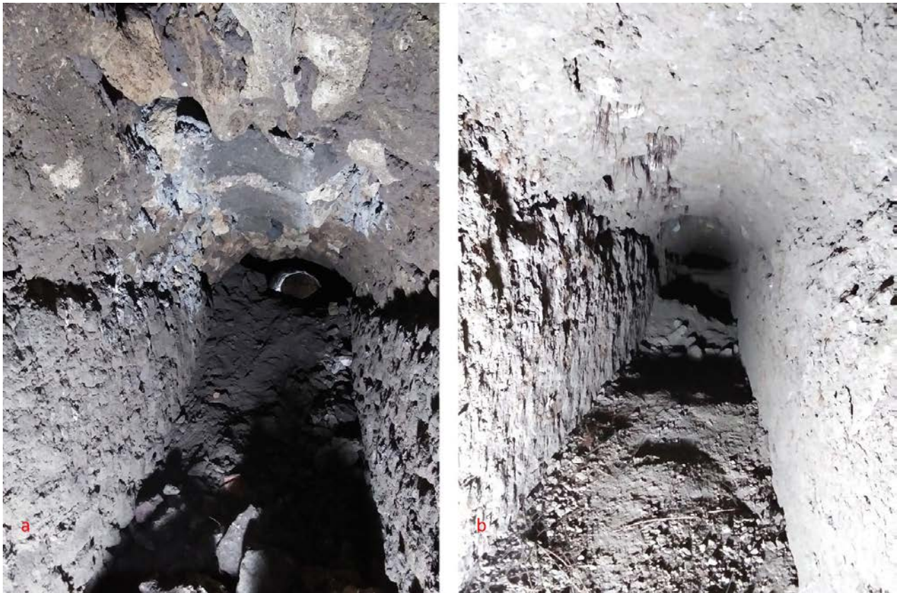
Fig. 16. Secondo segmento del tratto c: a sinistra l'ostruzione vista da monte; a destra lo stesso interro da Sud (foto Autore).
