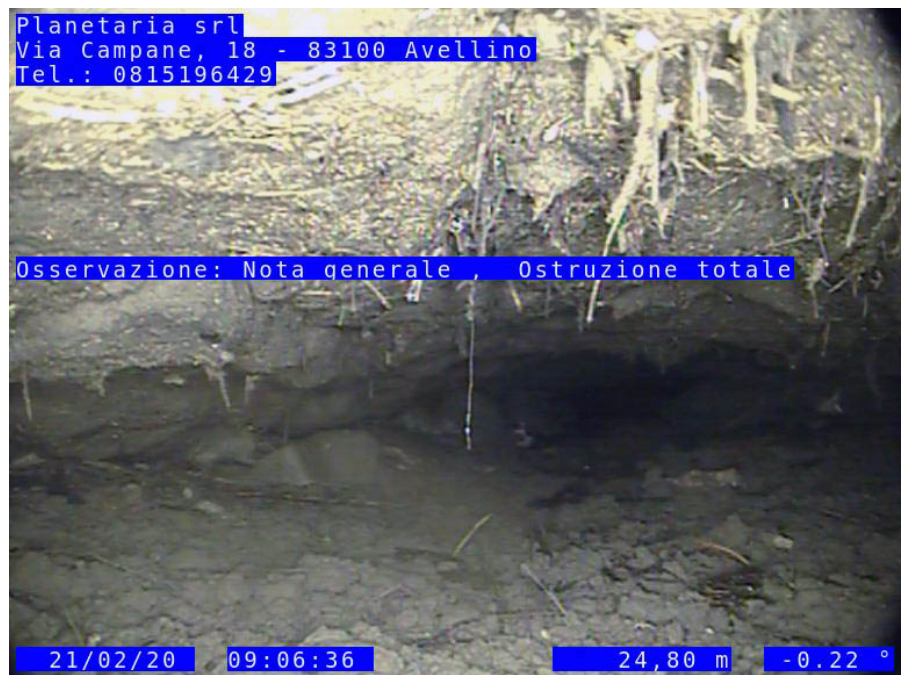
Fig. 5. Ostruzione completa del collettore a circa m 24.80 da 114 fotografata dall'interno del collettore fognario dal robot teleguidato ipek rovia rx 130.
