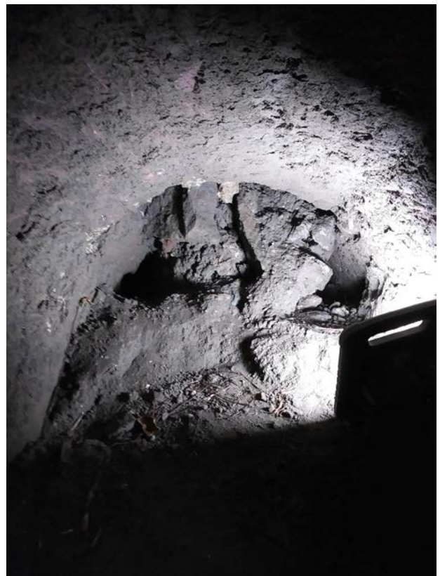
Fig. 19. Probabile cedimento della volta del tratto c del collettore in prossimità della sua terminazione meridionale (foto Autore).
