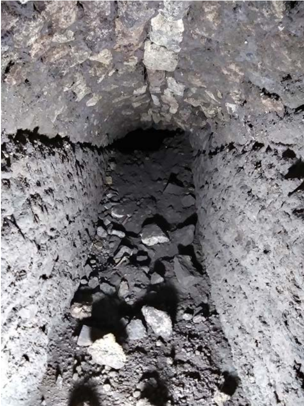
Fig. 17. Accumulo di sedimenti riscontrato all'interno del tratto c (foto Autore).
